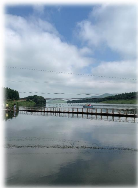
图 1 一段年久失修的木桥
